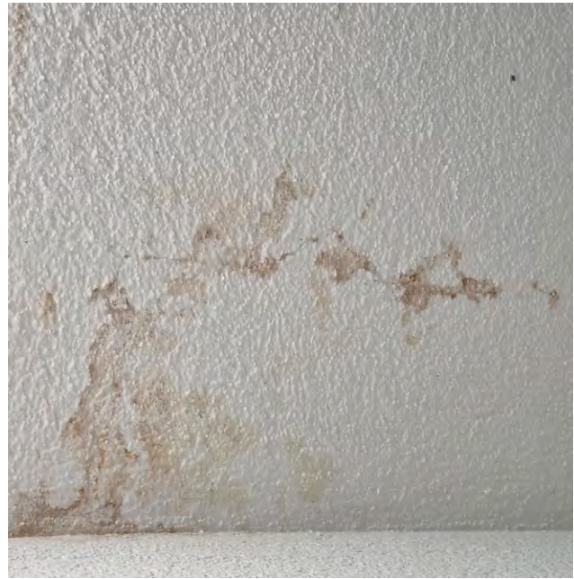
Abbildung 2: Verfärbungen Decke WC
