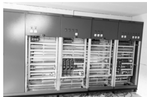
(Teil der neuen Steuerung)
